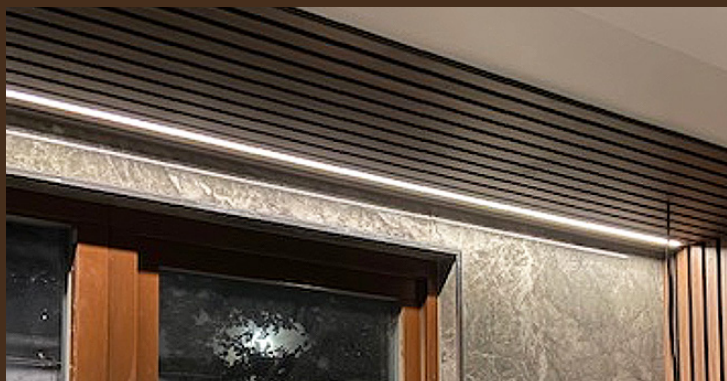
Ljusskena monterad i tak.
